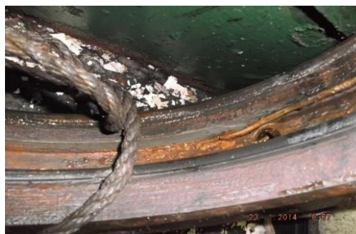
Gambar 2. kerusakan Simplex seal
